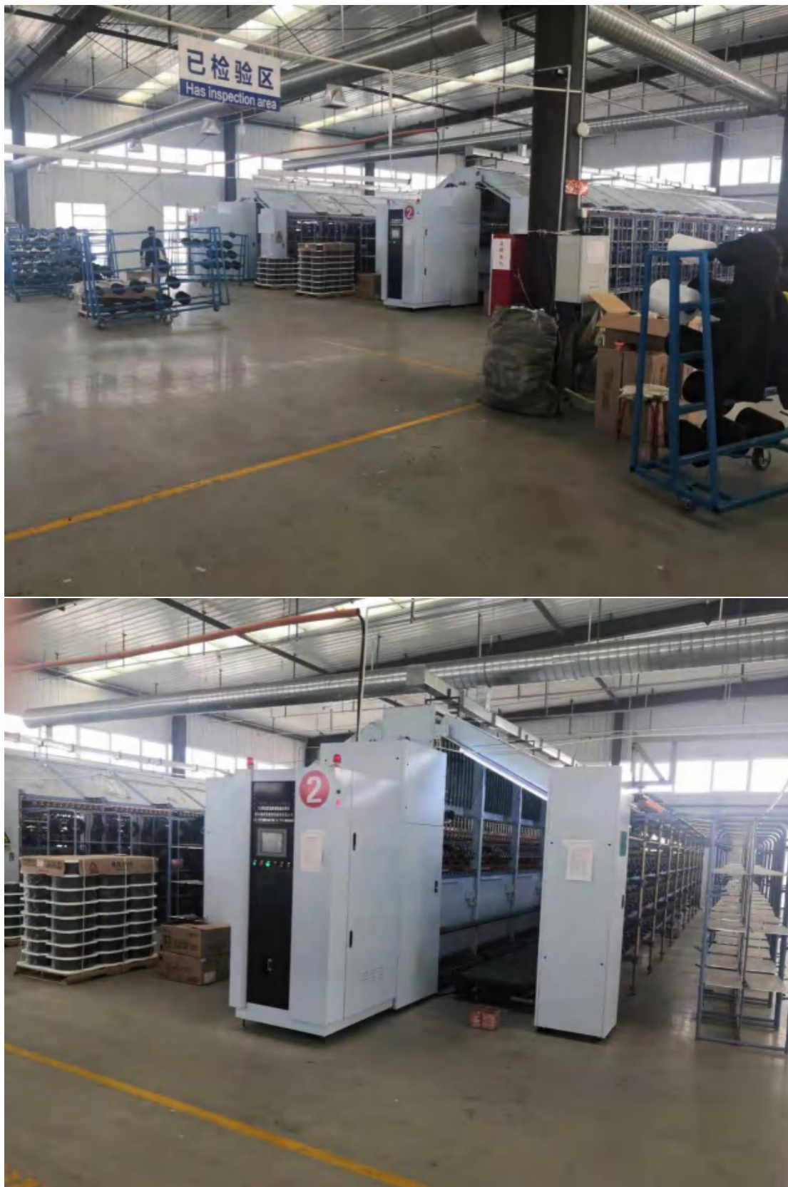
图 3-1 废气治理设施现场图
